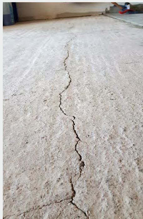
Absence de renfort suite à une ouverture
