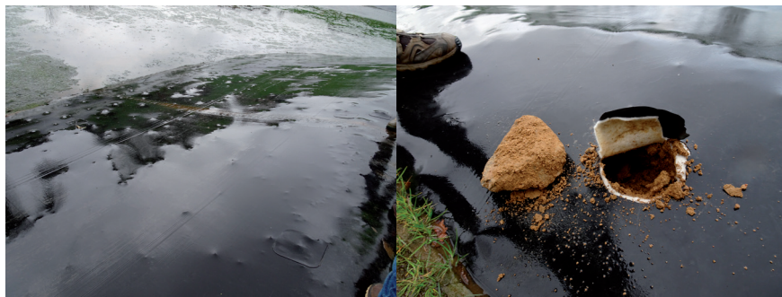
Présence d'éléments saillants en sous face de la géomembrane Crédit photos : Bernard MAUCO
