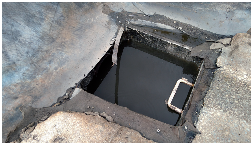
Fixation mécanique défectueuse Crédit photo : Yves GÉRARD
