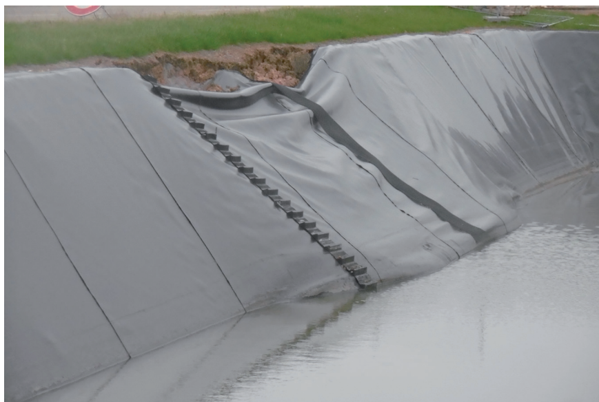
Glissement du dispositif d'étanchéité Crédit photo : Hervé LOISON
