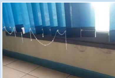
Infiltration allège de menuiseries alu.
