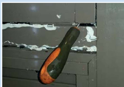
Montant de jalousie en partie basse non drainé vers l'extérieur.
