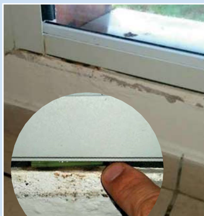
Infiltration sous jalousie
