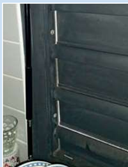
Défaut d'assemblage montant traverse.
