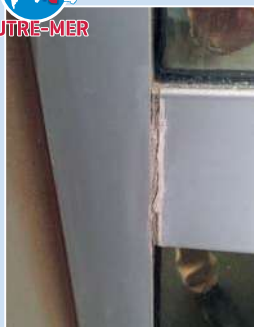
Défaut d'assemblage montant traverse.
