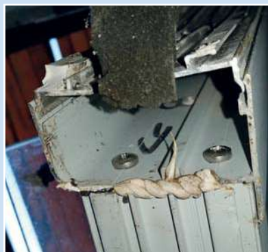
Vue de la partie basse d'un montant non drainé.
